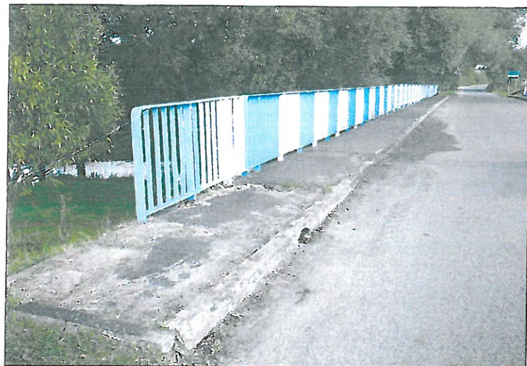
fot. 10. Degradacja nawierzchni chodnikowej w strefie skrzydeł.
