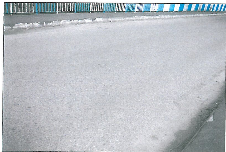
fot. 12. Dość przywoity stan nawierzchni bitumicznej na moście. Blisko 15 letni okres eksploatacji spowodował ogólne zestarzenie się nawierzchni oraz jej starcie.
