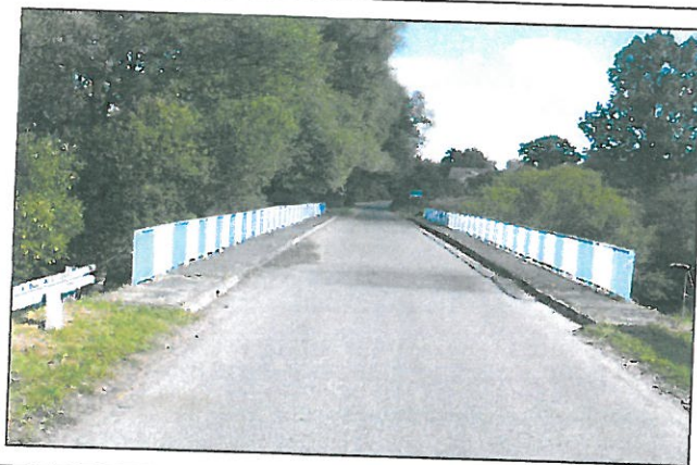
fol. 2. Widok ogólny mostu z „góry” w kierunku Poczernina. Spełnione wszelkie parametry dla ruchu samochodowego i pieszego. Balustrady stalowe do zabezpieczenia antykorozyjnego. Brak barier energochłonnych i oznakowania obiektu (nośność i nazwy rzeki).
